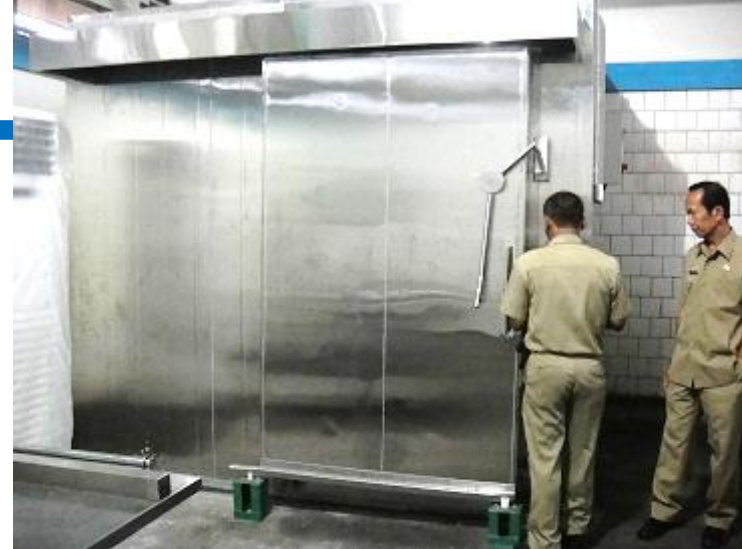
写真：急冷用冷凍庫(容量2.5トン)(上)、 保冷库(容量7～8トン)(下)
