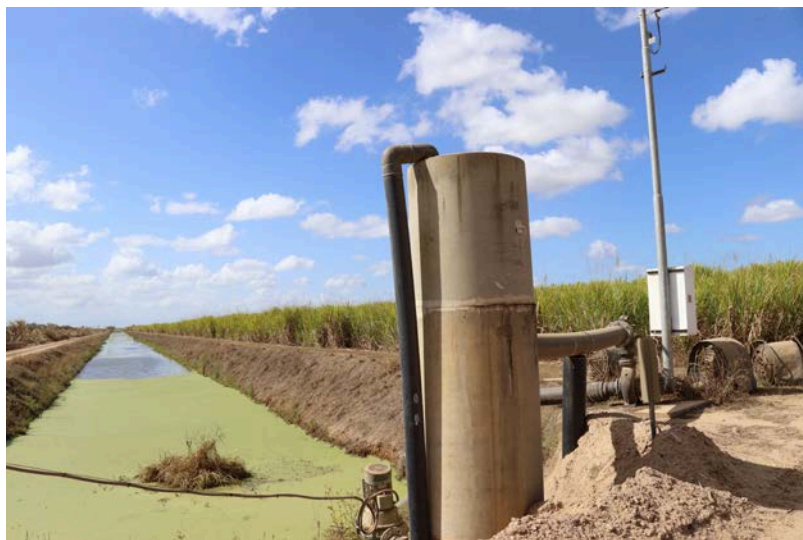
ポンプによる取水システム
