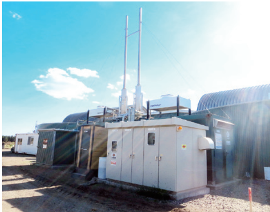
写真9 バイオガスプラント
