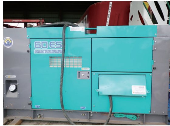
写真6 地震後に導入した定置式発電機 (太田牧場提供)
