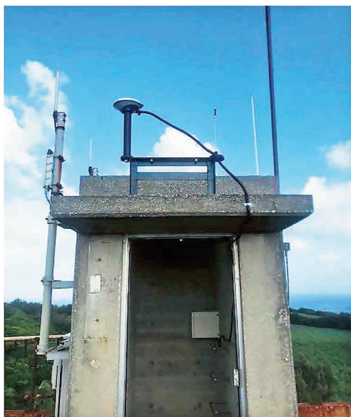
写真2 基地局アンテナ（高所に固定）
