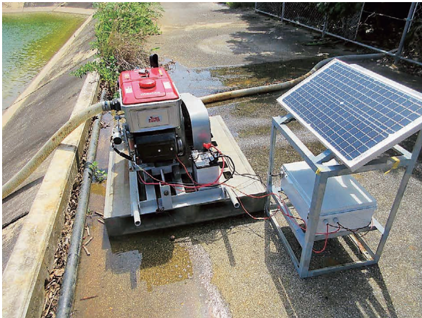
写真5 遠隔かん水システム（エンジンポンプ）
