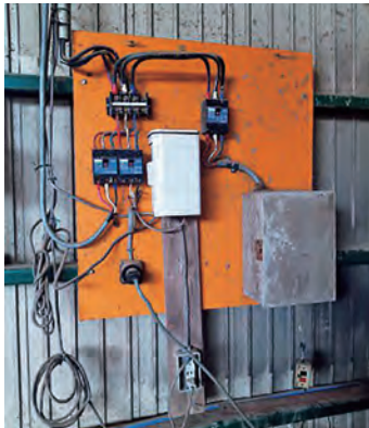
図9 むき出しの配電盤
