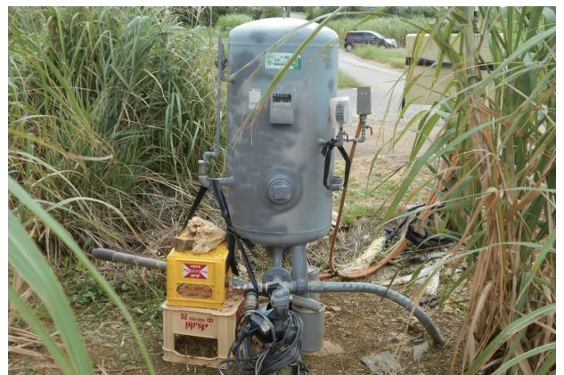
写真15 かん水用給水圧力タンク
