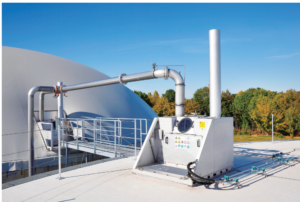
写真1 メタン発酵槽とバイオガスホルダー
