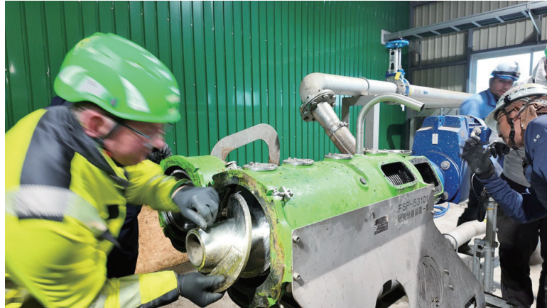
写真7 消化液の固液分離装置のメンテナンス
