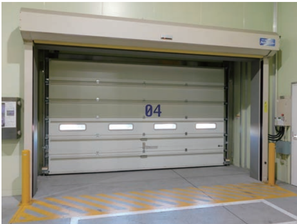
写真6 RORO船専用積込プラットフォームの出庫口
