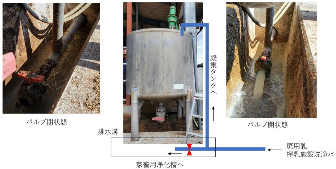
図3 凝集タンク・家畜用浄化槽への流路切り替えバルブ (A 牧場)
