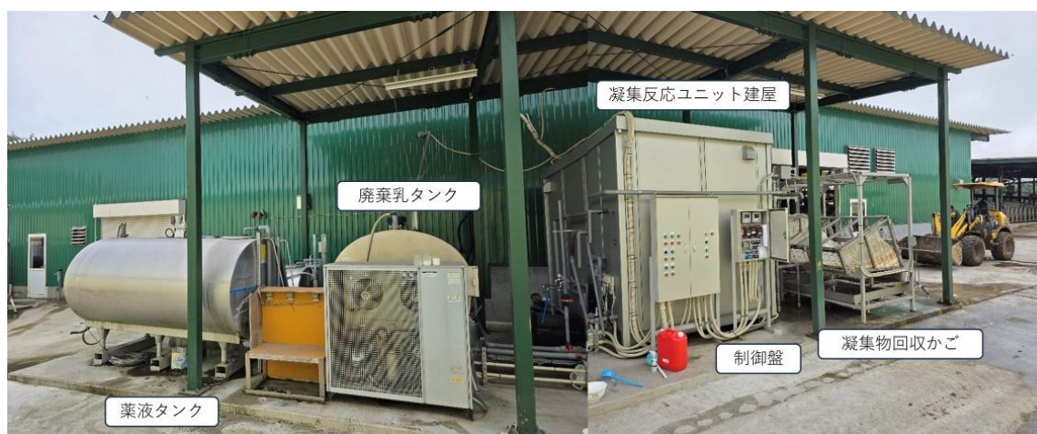
図11 凝集反応装置の設置状況
